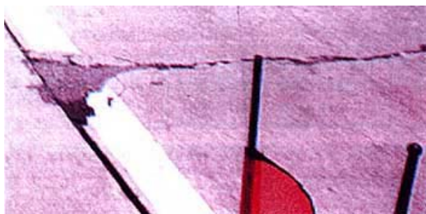
Slika 6. Detalj oštećenja kolnika povećanjem ("zumiranjem") dijela snimke visoke rezolucije
