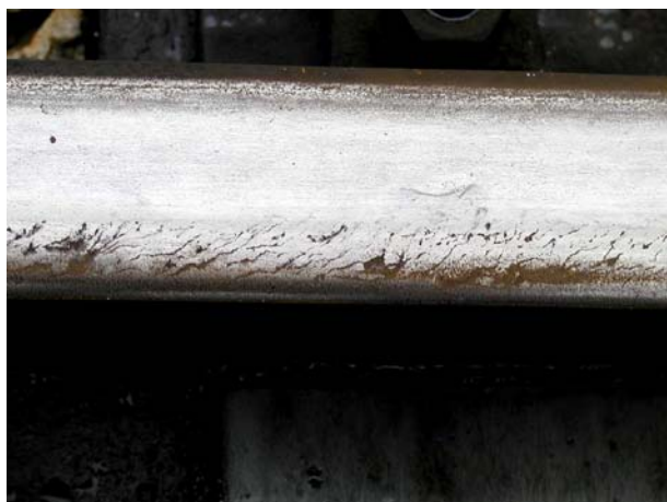
Slika 1. Oštećenja na voznoj površini tračnice
