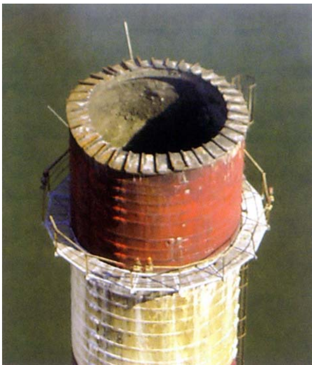
Slika 2. Glava dimnjaka prije sanacije
