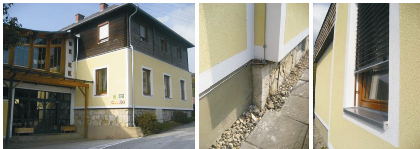
Stara školska zgrada – zidano podnožje sa saniranim plaštom, toplinska zaštita vanjskoga zida u dijelu koji se grije, svi prozori izloženi sunčevu zračenju imaju sjenila
