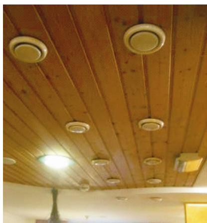
Primjer izvedbe prozračivanja u blagovaonici
