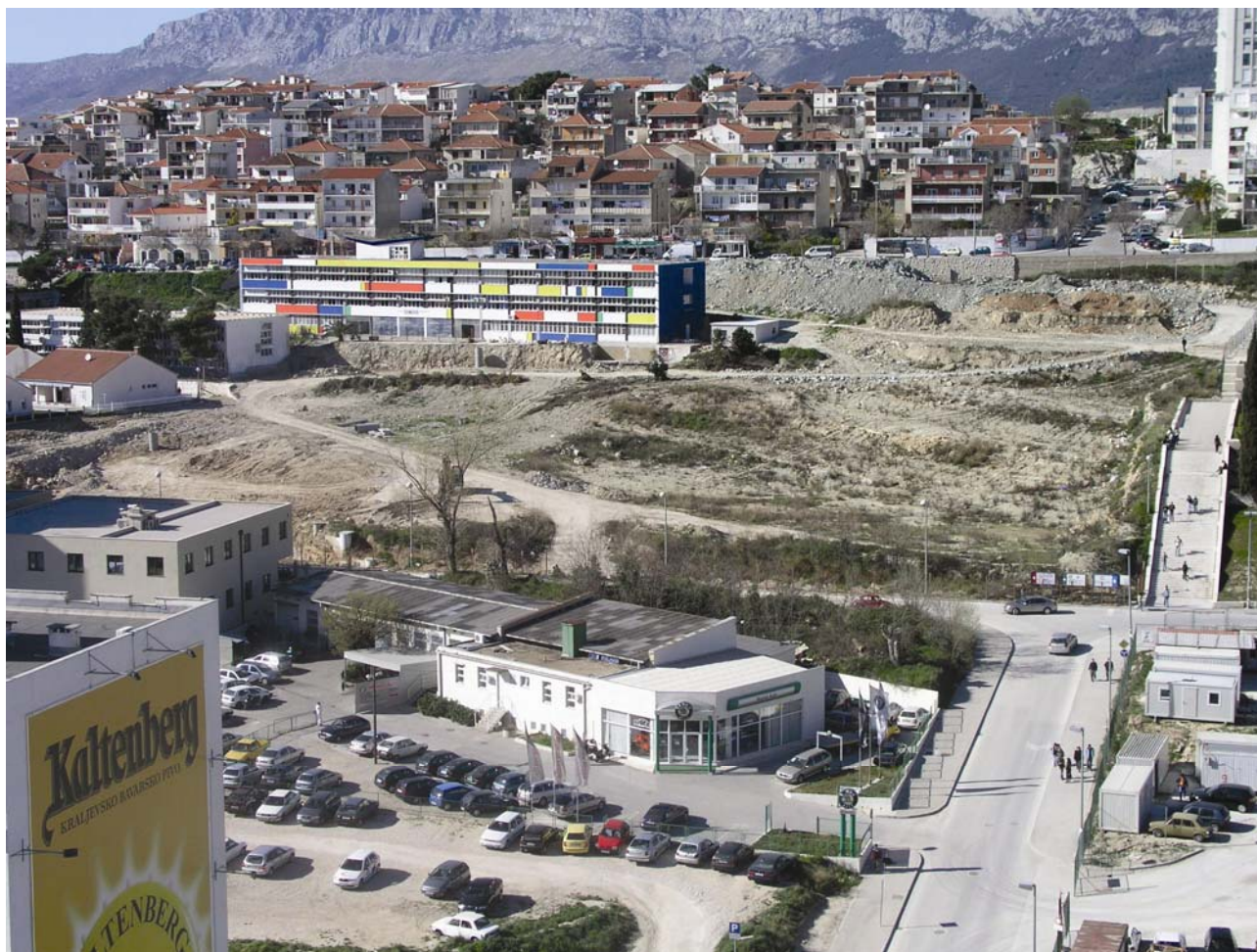
Očišćen teren za gradilište studentskog centra i studentskog doma (iznad je zgrada bivše vojarne koju koristi Umjetnička akademija)
