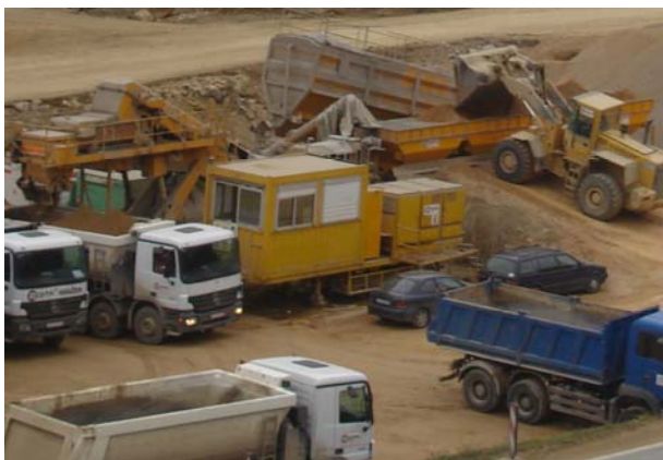
Slika 3. Postrojenje za proizvodnju stabilizacijske mješavine kontinuiranog tipa
