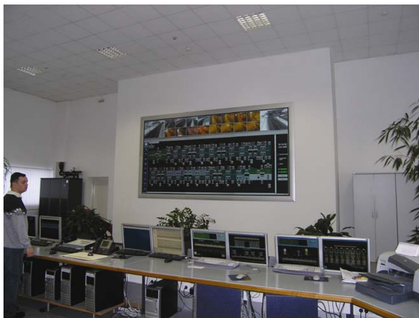
Centar za kontrolu prometa tunela Mala Kapela
