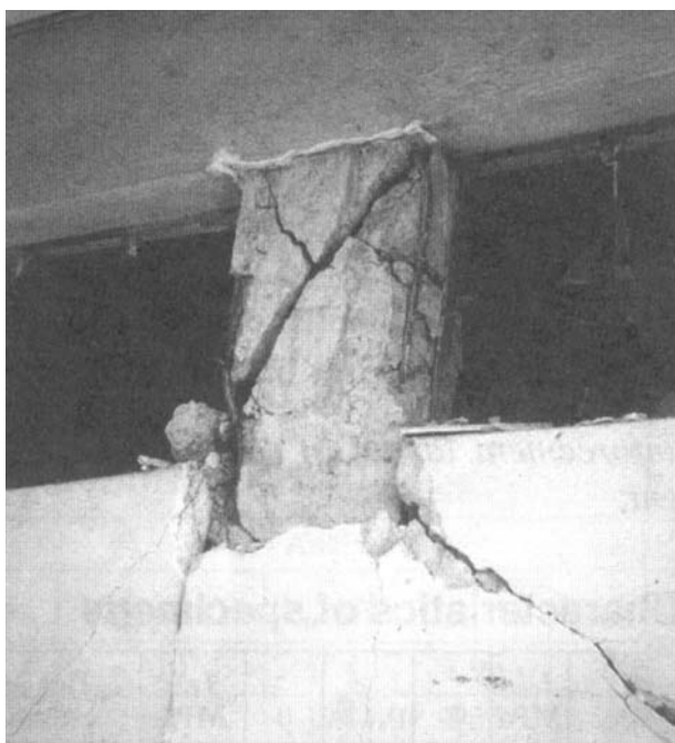
Slika 1. Stup oštećen potresom 1999. godine u Grčkoj
