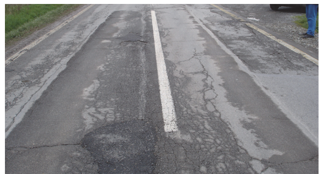
Slika 1. Asfaltni zastor tijekom uporabe (granične uporabne vrijednosti)
