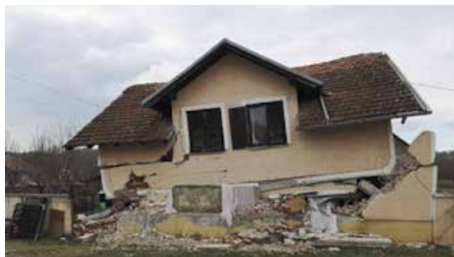
Slika 25. Urušena obiteljska kuća u selu Prekopa zbog fleksibilnog prizemlja i snage potresa
