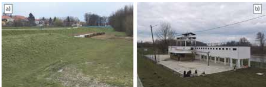
Slika 21. a) Uleknuti zemljani nasip na prilazu kupališnom objektu; b) Kupališni objekt u Petrinji uz Kupu
