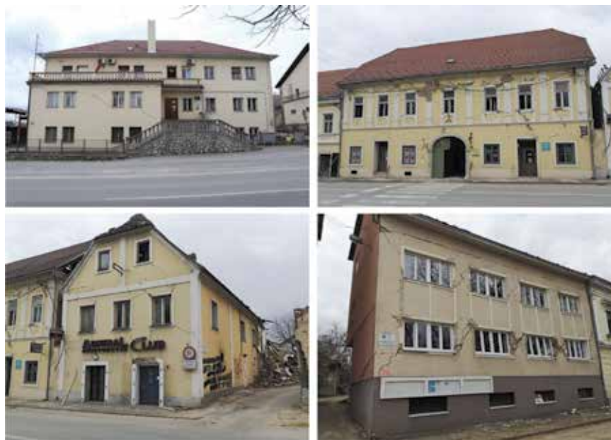
Slika 20. Neke zgrade u Petrinji s tipičnim oštećenjima nosivih zidova na pročelju
