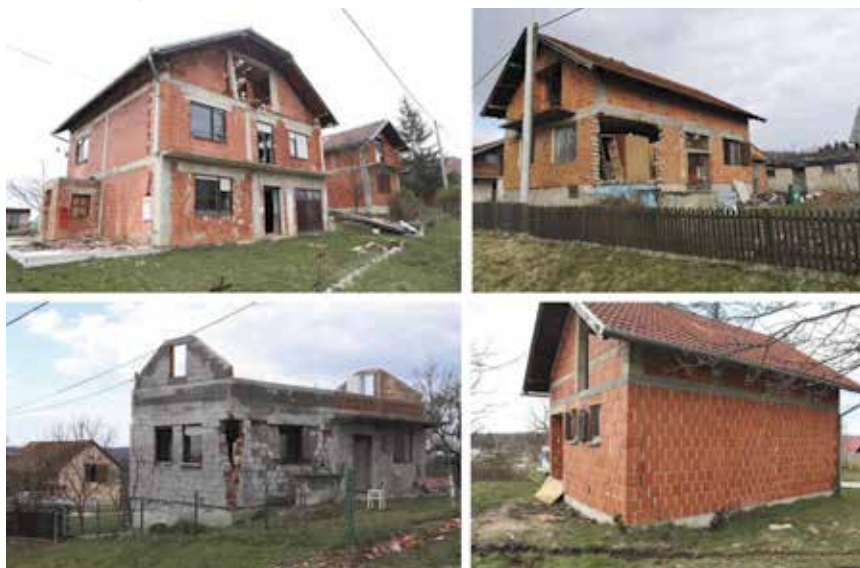
Slika 23. Neka karakteristična oštećenja obiteljskih kuća u Novom Selu Glinskom
