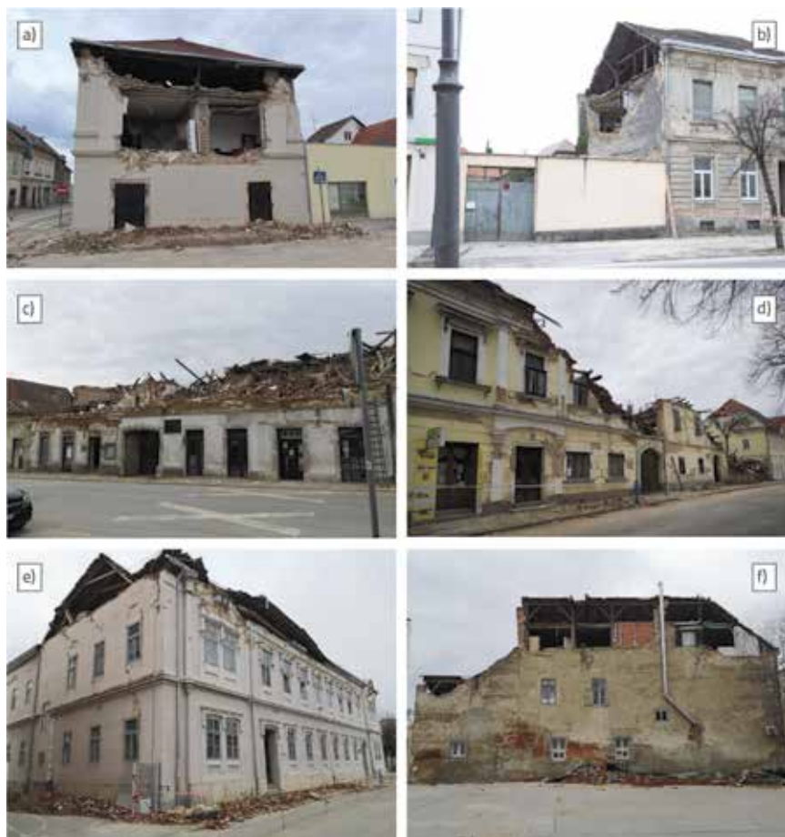
Slika 19. Neke zgrade u Petrinji s teškim oštećenjima zabatnih zidova i drvenog krova
