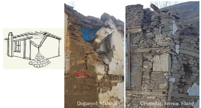
Slika 16. Klinasta oštećenja u kutovima
