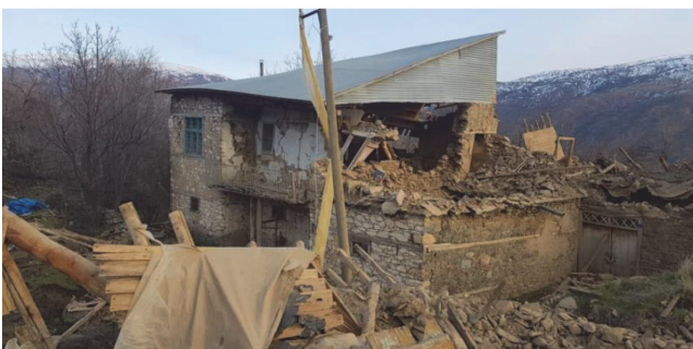
Slika 25. Srušena zidana kuća u donjem dijelu sela Cevrimtaş (građevina br. 4)
