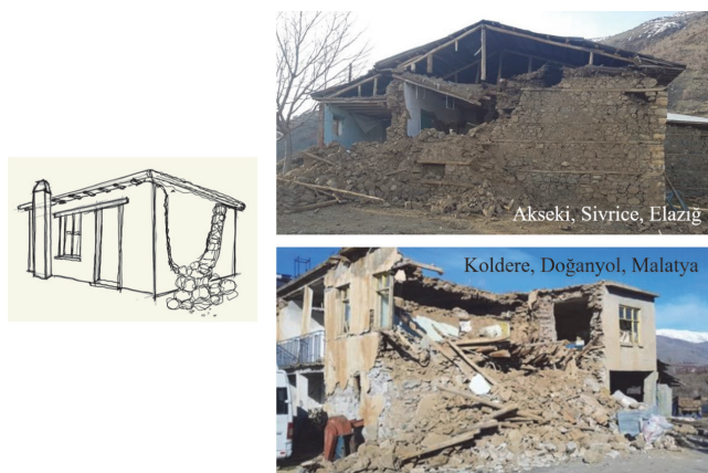
Slika 19. Popuštanje zbog odvajanja zidova
