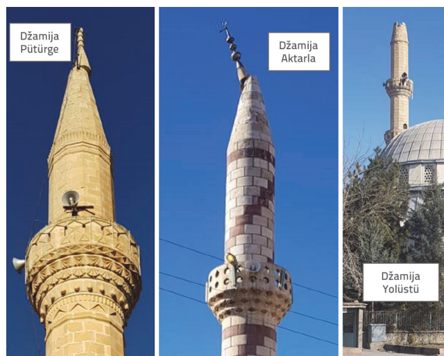
Slika 27. Oštećenje minareta zbog odvajanja alema od stošca
