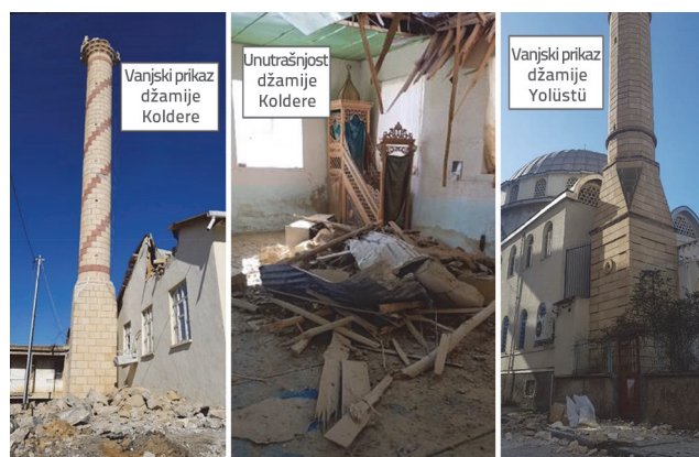
Slika 28. Oštećenje zbog pada odlomljenoga materijala
