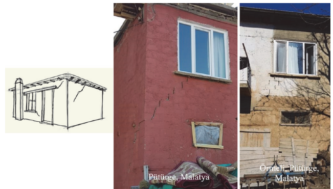
Slika 17. Pojava dijagonalnih pukotina na zidovima
