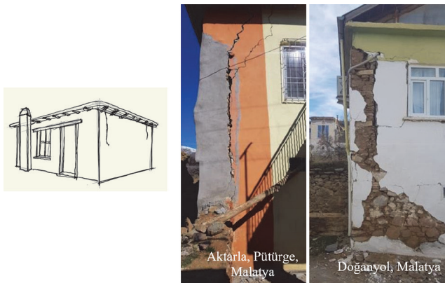
Slika 15. Vertikalne pukotine i pucanje u kutovima
