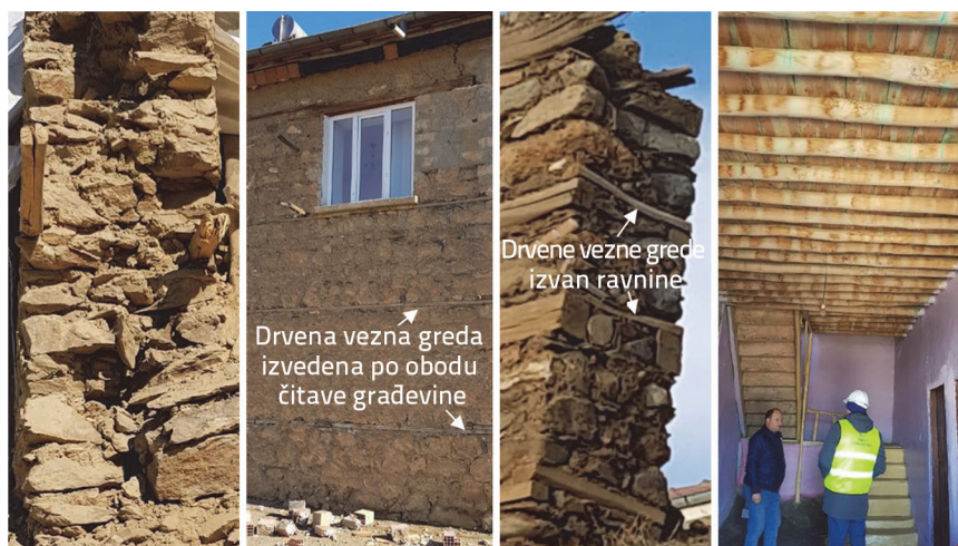
Slika 14. Detalji zidanih građevina tipičnih za to područje: a) presjek zida, b) drvene vezne grede, c) izvanravnske vezne grede, d) katna konstrukcija
