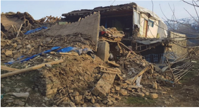
Slika 22. Srušena zidana kuća u donjem dijelu sela Cevrimtaş (građevina br. 1)
