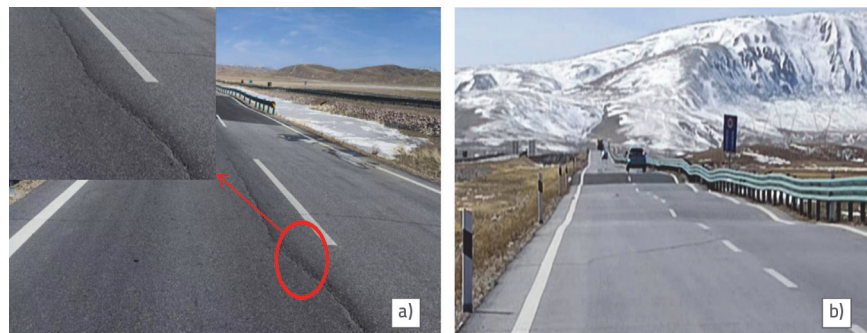
Slika 2. Stanje GongYu autoceste: a) Uzdužna pukotina; b) Nejednoliko slijeganje ceste
