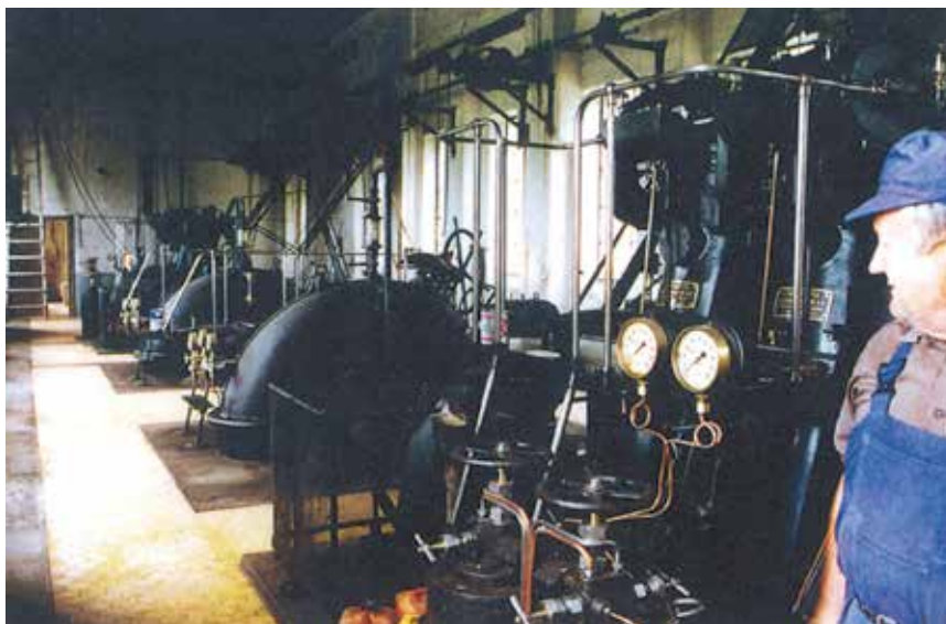
Slika 6. Strojarnica crpne stanice Konjuša, k.o. Gunja, 1932.
