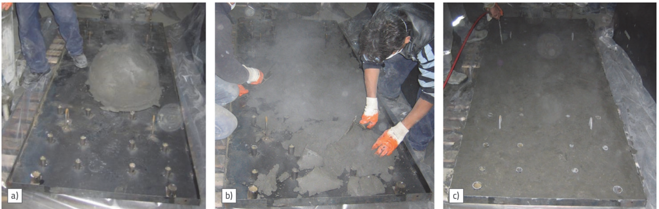
Slika 13. Slijed proizvodnje ploče: a) ugradnja betona; b) rasprostiranje betona; c) završna obrada
