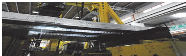
Slika 19. Pukotine u stropnoj ploči prije loma
